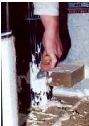
Photo A - Système Laine de roche + Enduit : Traitement d'une botte de câbles à l'enduit
