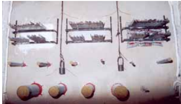
Photo E - Complexe de différents systèmes : Laine de roche + enduits, mortier, sacs, colliers, pâte intumescence
